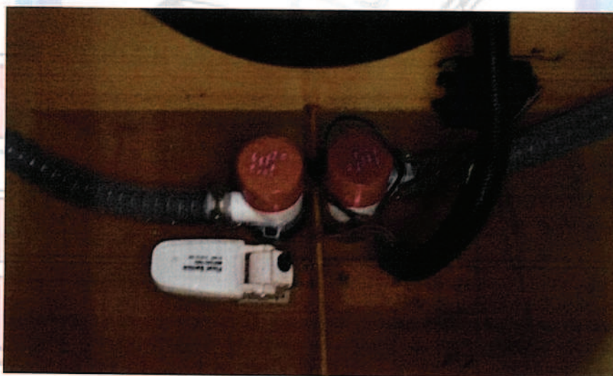
Foto 9: Bombas de esgoto.
